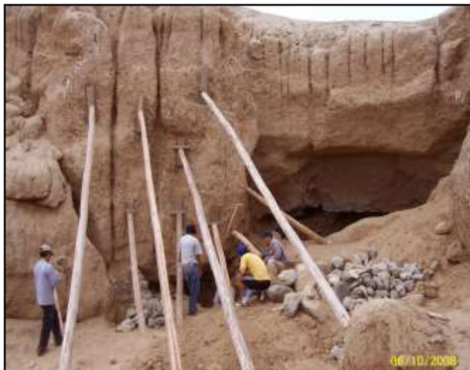
Fig. 4. Para evitar el colapso, se reforzó el piso y se apuntalaron los bloques en colapso. Esto es eventual y por el momento.
