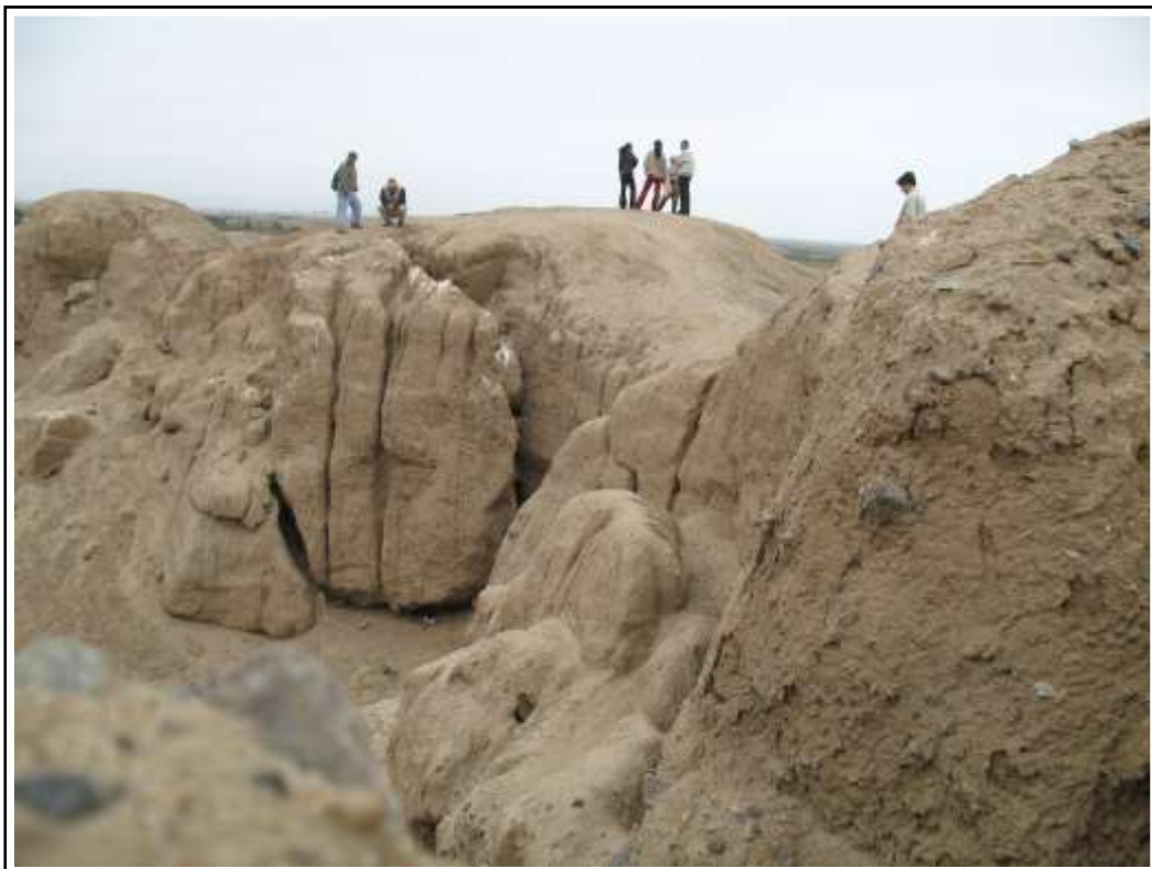
Fig. 2. Enorme y grave fractura en el mausoleo de Chayhuac, producida –posiblemente- por una falla geológica, la que corre paralela al mar desde el Alto Salaverry hasta Huanchaco. “Falla de Huamán”
