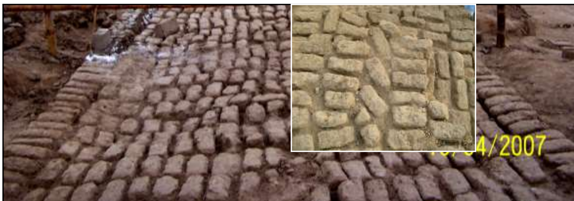
Fig. 5. La falta de engranaje en los adobes, en ambas fotos, en la base del muro perimetral, bien pudo haber causado el fácil derrumbamiento de esa construcción. Se advierte que –a lo más- sólo se los acomodó. En otros, ni eso. Las hiladas exteriores siempre se desprendieron, generando su colapso como se verá en otras fotos.
